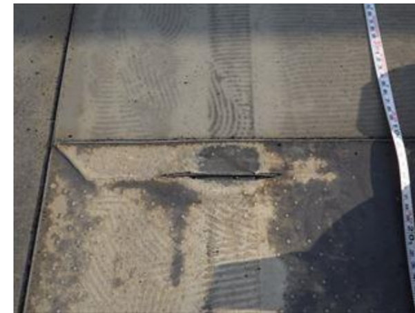
図 2.10 防水シート傷と周囲の汚れ
