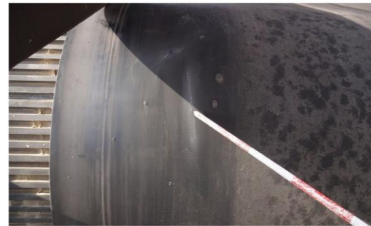
図 2.5 水平ヘルムコンベヤ (ヘルム亀裂)
