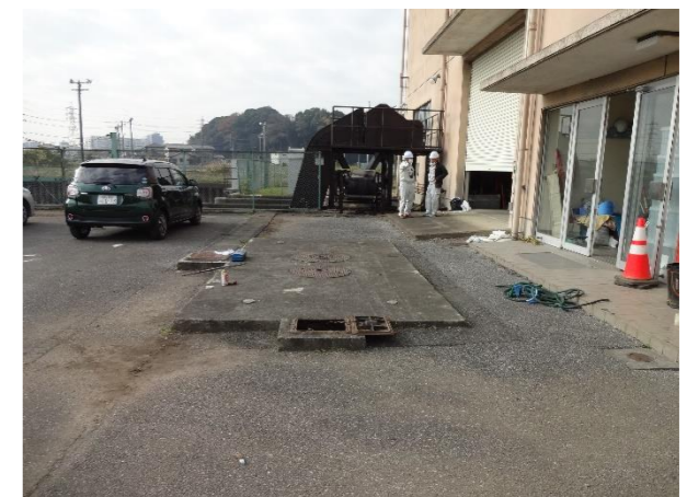
図 2.13 地下重油槽周辺地盤の沈下
