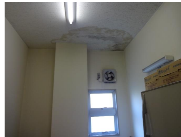
図 2.12 雨水進入状況
