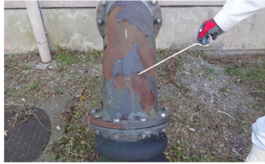
図 2.2 No. 1 雨水ポンプ吐出管
