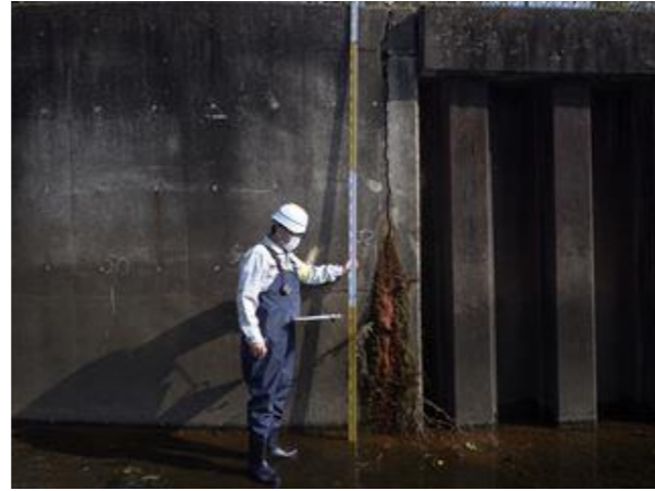
図 2.15 上流側護岸工南端の剥離
