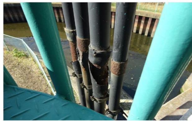
図 2.9 ゲート操作盤 (屋外配管)
