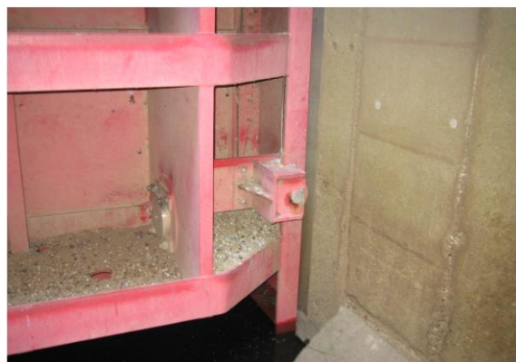
図 2.8 吐出樋門 (鳥糞堆積)
