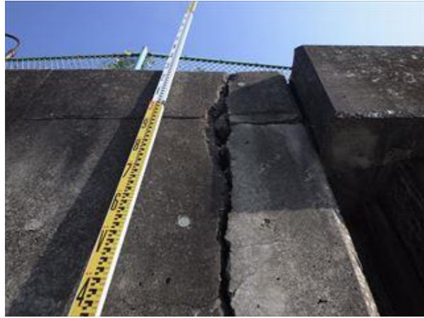
図 2.14 上流側護岸工南端の剥離
