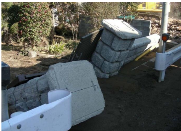
(震災により倒壊した門柱：我孫子市都地先)
