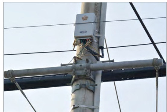
配電用の箱(低圧引込接続箱)中で繁殖するスズメ
