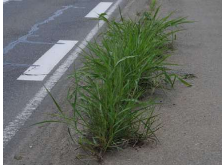
▲歩道と車道のコンクリートの隙間に根を張るセイバンモロコシ
