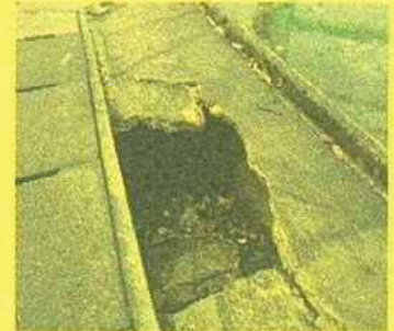
南新木調整池 側溝陥没
