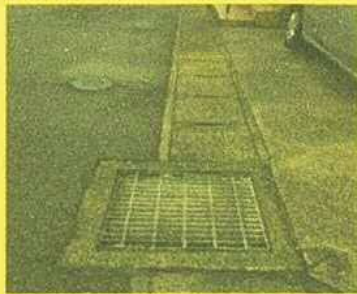
側溝 注意 水流により 敷き蓋が はずれる
