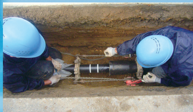
▲耐震管接合状況
