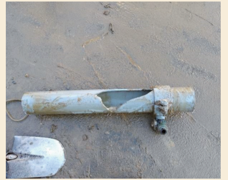
▲破損した塩化ビニル管
