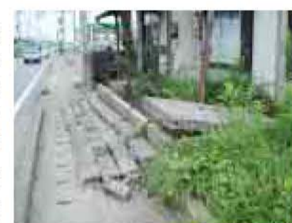
鉄筋や控壁(支え)がなく歩道へ倒壊した塀
