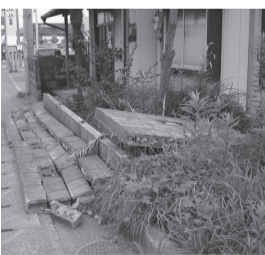
歩道に倒壊したブロック塀(中越沖地震)
